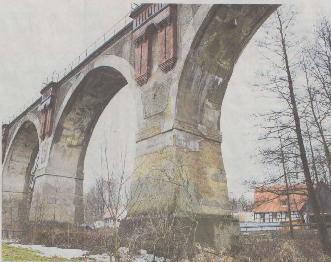
Die Heidelbachbrücke. Sie liegt unweit der thüringisch-sächsischen Landesgrenze, noch auf Niederhainer Territorium. Die Schäden an den Pfeilern sind bereits deutlich sichtbar. Foto: Ilka Jost
